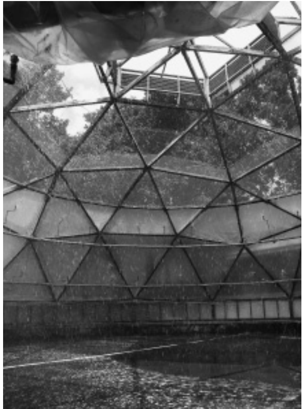
ドームハウスのかん水装置。直径14m、高さ8m、風と太陽を利用して水分を蒸発させていく。
