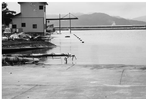
図9 寺間漁港の沈下状況。
